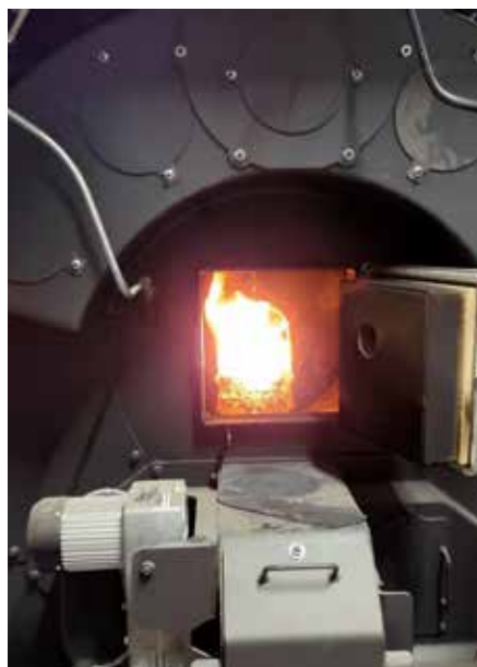
Herzstück der Anlage
